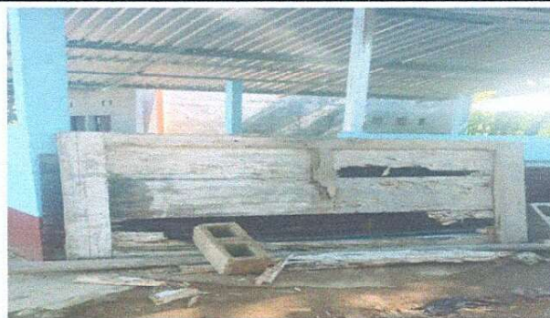
Foto 4: Desistacion de la puerta de la cocina.
